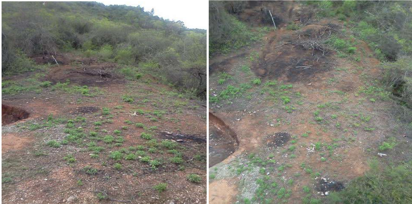
Figura N° 14 y N°15. Imágenes del lugar de construcción del nuevo tanque elevado. Fuente: Autor (2017).
