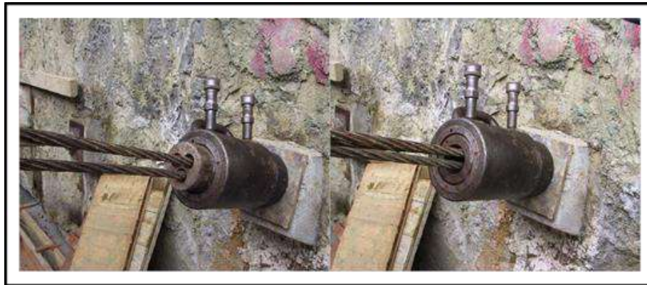
Figura 10. Proceso de tensado de los anclajes. Fuente: Información tomada de los documentos y expedientes con autorización de FF.
