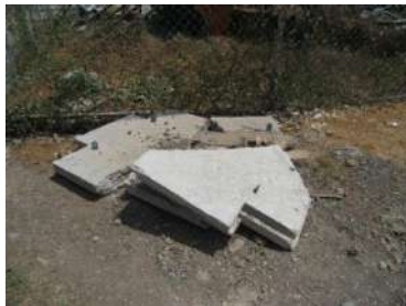
Figura 42: Escama fracturada Fuente: Archivos Tierra Armada
