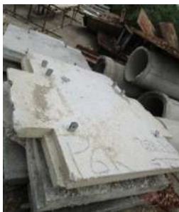
Figura 32: Escama con daños en bordes Fuente: Archivos Tierra Armada
