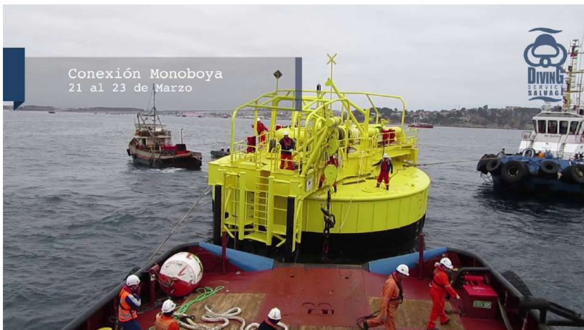
Figura N° 15 Construcción de Monoboya de Llenado de Tanqueros Petroleros Fuente: Cortesía de Diving Services Salvage, con fines académicos
