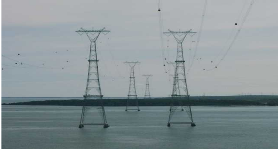
Figura 2-2 Línea de Transmisión Aérea. Colorado, D. Dossier Fotográfico.
