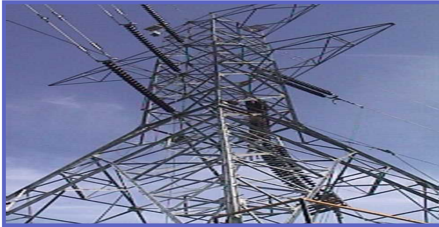
Figura 2-7 Línea de Transmisión Multicircuito. Colorado, D. Dossier Fotográfico.
